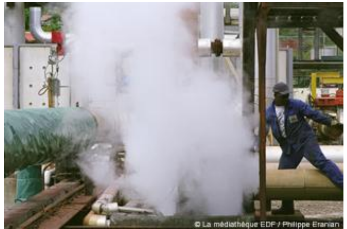
Centrale géothermique de Bouillante (Guadeloupe)
