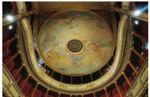
Vue avant restauration du plafond central de la salle à l'italienne, 1899 © Yves-Pierre Veracruz
