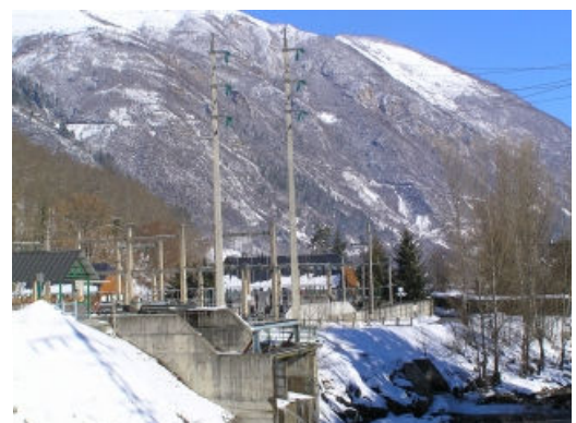
Départ de l'électricité vers le réseau
