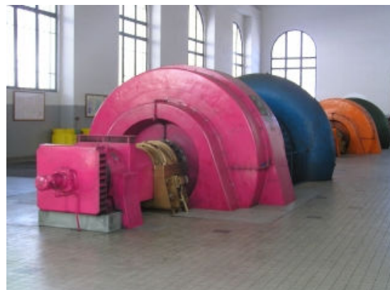
Turbines et alternateurs
