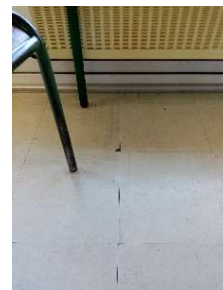
Dalles de sol en vinyle amiante dans une école
