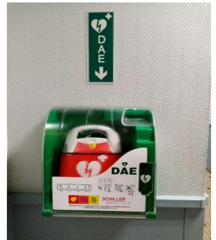
DAE installé dans un collège
