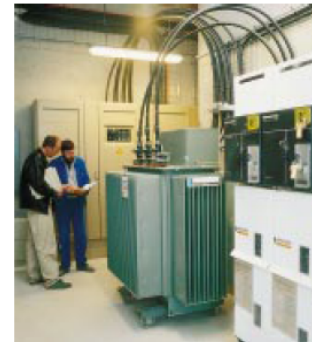
800 kVA - 20 kV / 400 V
